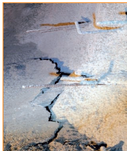
■ [Foto 5].- Grietas en el hormigón proyectado colocado en 2007.
