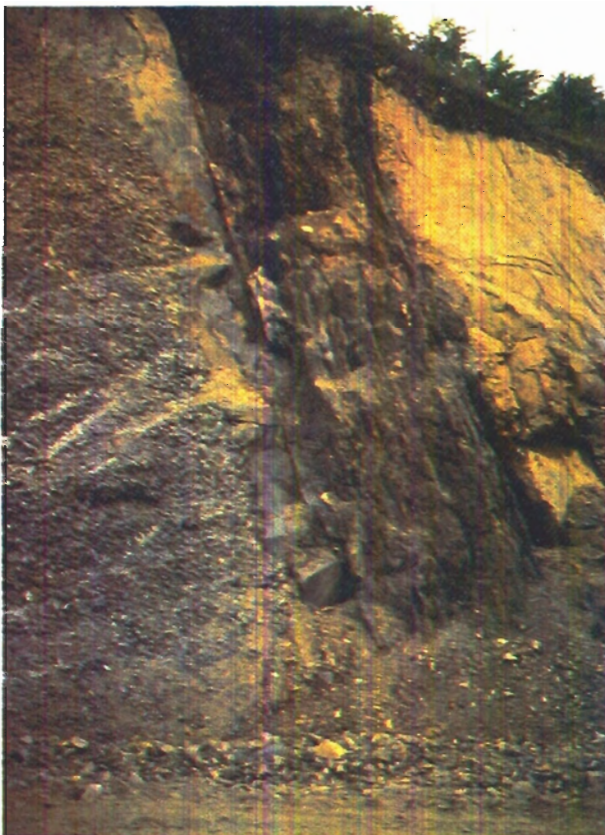
Foto 1. Discontinuidad producida por la estratificación.
